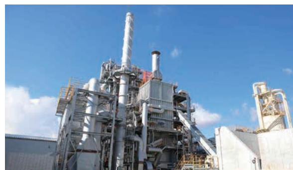
C 環境に配慮したバイオマスボイラー
