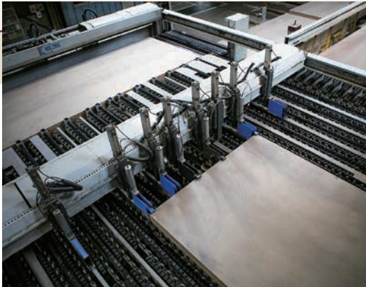
パーティクルボード加工設備
