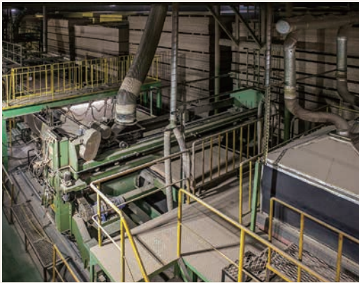
パーティクルボード生産設備
