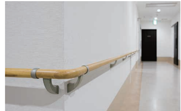
1階・2階 廊下： コーナーから壁沿いに設置された安心の手摺
