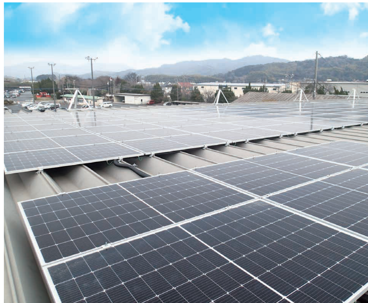
山口・平生事業所に設置された太陽光発電設備
