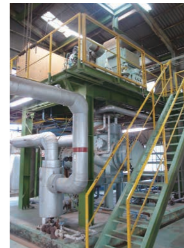
バイオマス発電機(山口・平生事業所)
