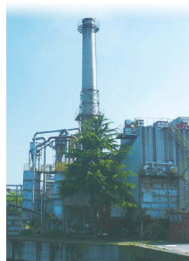
バイオマスボイラー（敦賀事業所）
