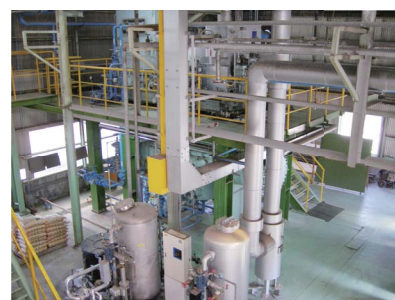
バイオマス発電所(山口・平生事業所)
